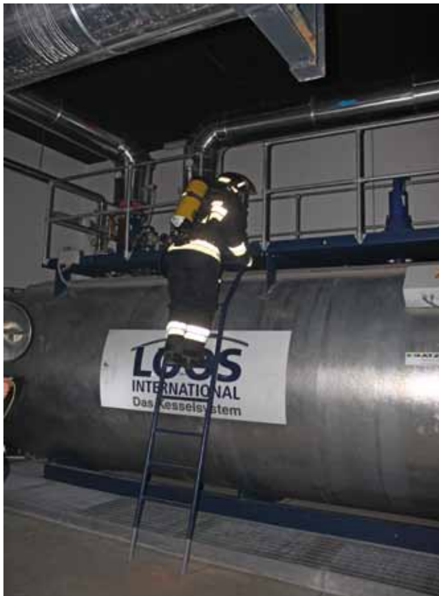
Si verifica il deposito olio diatermico a 315 gradi centigradi
