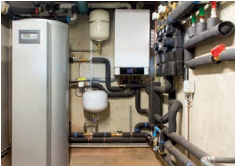
LOCALE CALDAIA CON CALDAIA A GAS A CONDENSAZIONE E SERBATOIO SOLARE PER ACQUA CALDA
