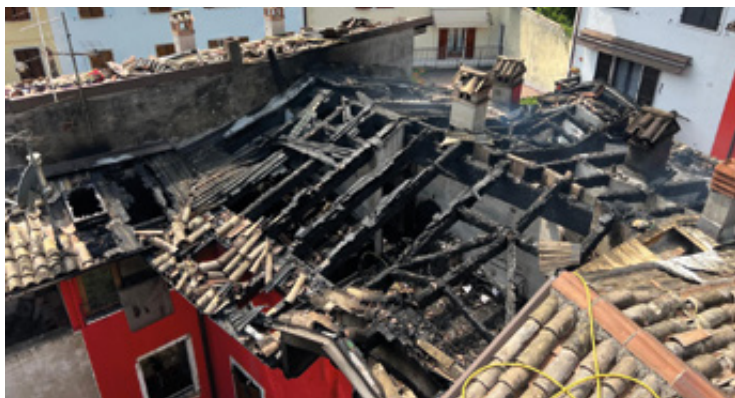
I DANNI PROVOCATI DAL ROGO
